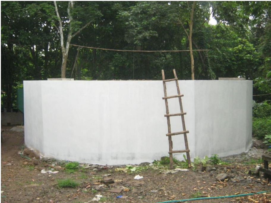
ถังพักน้ำ ขนาดความจุ 150 ลูกบาศก์เมตร
