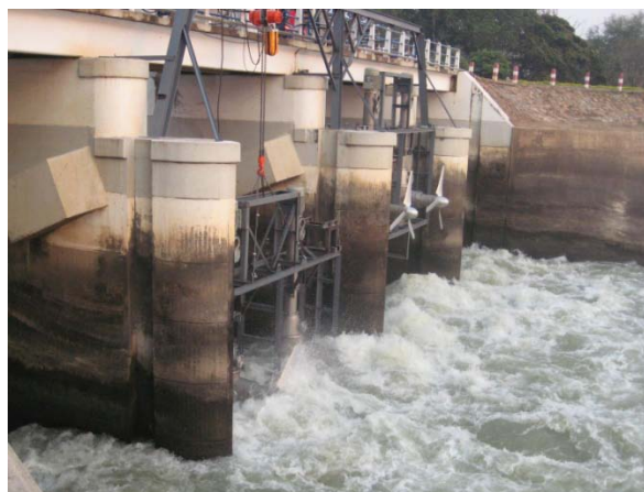
กำลังการผลิตไฟฟ้ารวม ๘๐ กิโลวัตต์ ชุดกังหันติดกับโครงเหล็กที่สามารถปรับขึ้น-ลงได้ด้วยรอกไฟฟ้า
